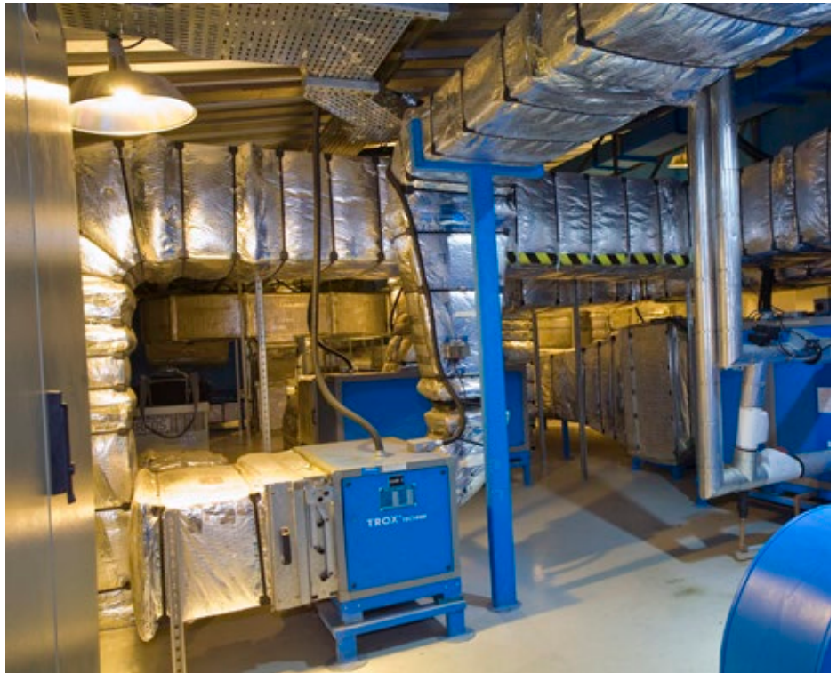
Vista parcial do piso técnico
